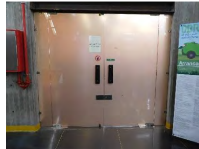
Puertas P4 en aulas, tiradores no accesibles
