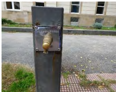
Grifo que requiere fuerza excesiva
