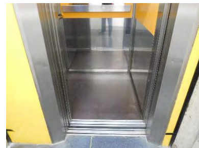
Inexistencia de pavimento señalizador
