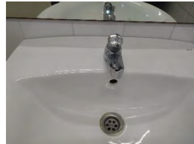
Grifería cabinas tipo C1, pulsador de fuerza excesiva
