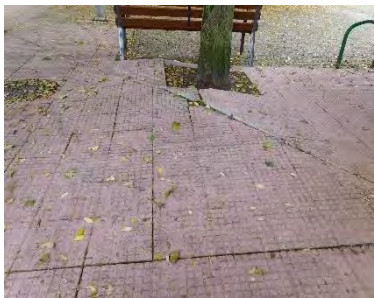
Acera interior pendiente excesiva y resaltes
