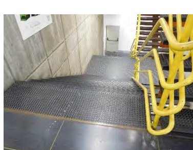
Embarques sin pavimento podo táctil
