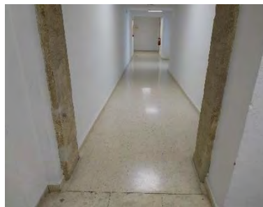
Rampas sin pavimento podo táctil
