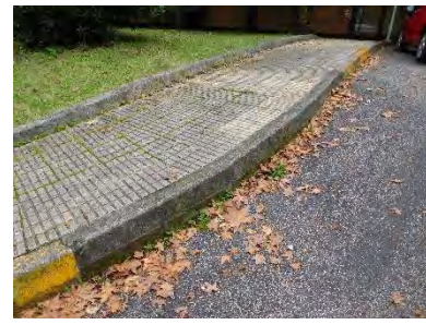
Pendiente longitudinal y transversal excesivas
