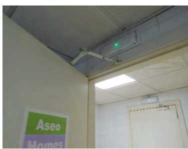
Retenedores que no se mantienen a 90° y requieren fuerza excesiva, P1
