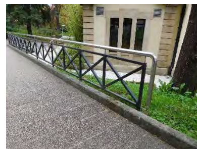
Barreras de protección escalables con huecos excesivos
