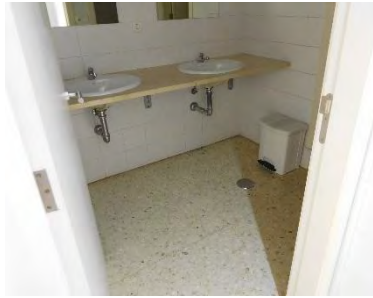
Núcleos sin cabinas adaptadas
