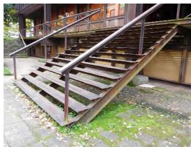
Escaleras con tramos superiores a 12 peldaños
