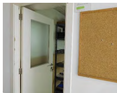
Puertas sin distancia suficiente al encuentro en rincón, en pasillos
