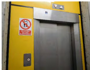
Inexistencia de nº de planta en jamba
