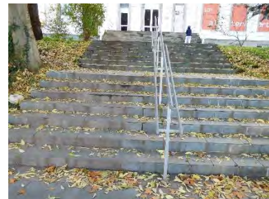
Barreras de protección con huecos superiores a los admisibles, Tipo E8
