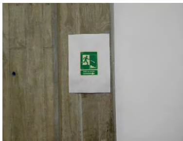
Señalización inadecuada en escaleras, en papel, Edificio Ferro
