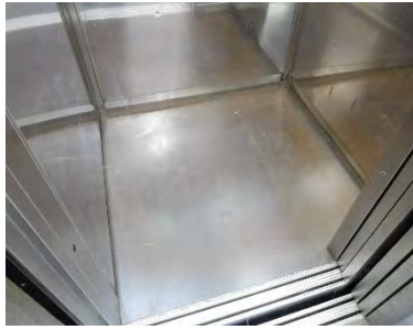
Cabinas inferiores a las requeridas
