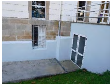
Espacio previo horizontal al desembarque de la rampa insuficiente, Acceso 2
