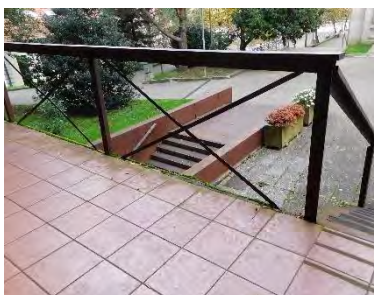
Barreras de protección escalables con huecos excesivos
