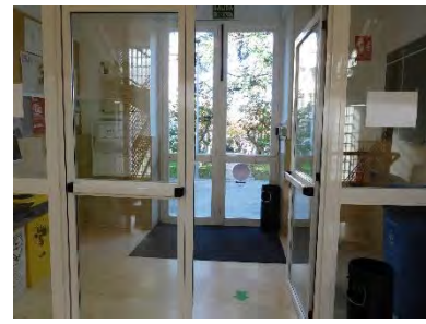
Puertas sin barras antipánico, Edif. 2
