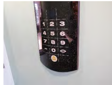
Botonera interior a altura excesiva
