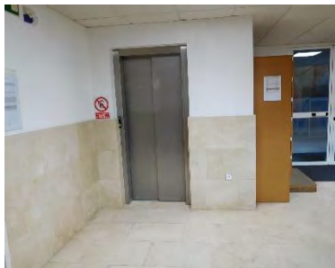
Inexistencia de nº de planta en jamba
