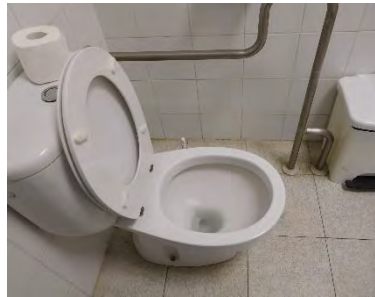
Inodoros con altura y longitud insuficiente
