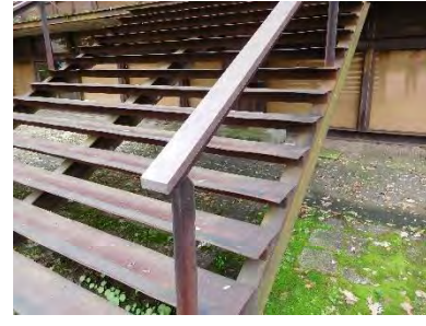
Pasamanos rectangular no adecuado, Tipo E1, E2, E3 E4 y E5
