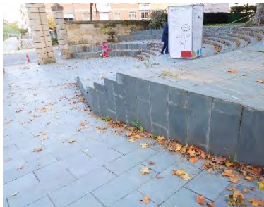
Desniveles sin protección en mesetas de escaleras
