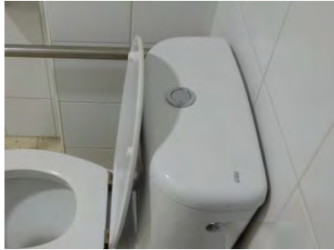
Mecanismo de descarga con superficie insuficiente
