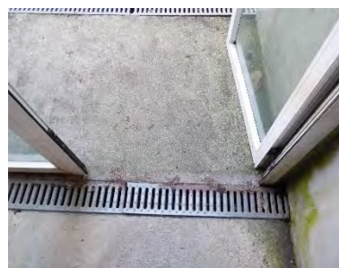
Ancho de puerta de 65 cm, insuficiente, Acceso 2
