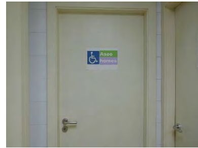
Cabinas adaptadas sin 150 cm en vestíbulo de acceso
