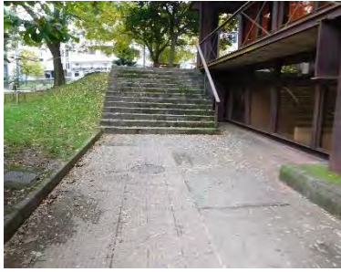
Escaleras E1 y E5, pasamanos en un solo lado.
