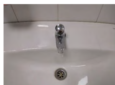
Grifería cabinas, pulsador de fuerza excesiva
