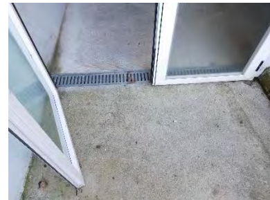
Ancho de puerta de 65 cm, insuficiente, Acceso 2
