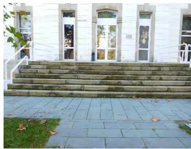
Escaleras sin pasamanos central
