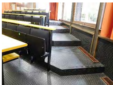
Aula escalonada con peldaños sueltos sin bandas
