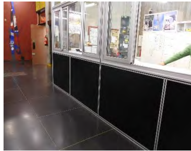
Punto de atención Edificio Ferro, sin pavimento táctil direccional ni espacio de aproximación
