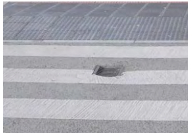
Rejillas rehundidas en medio de pasos peatonales
