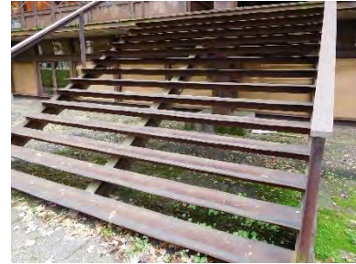
Escaleras E2 y E4 sin tabicas
