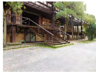
Escaleras sin pavimento podo táctil
