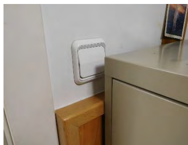
Interruptores de despachos y salas sin contrastar
