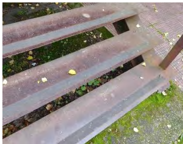
Escaleras sin señalización de borde de peldaños inadecuada( sin resistencia al deslizamiento ni contraste)
