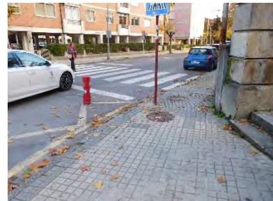
Paso peatonal sin pavimento podo táctil
