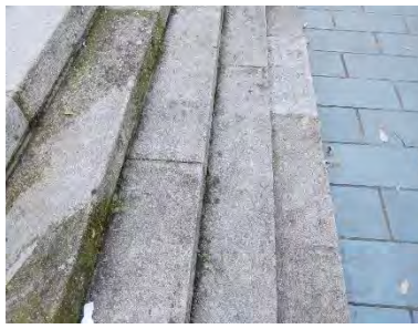
Escaleras sin señalización de borde de peldaños
