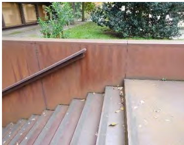
Escaleras sin prolongación en pasamanos
