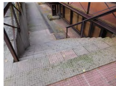
Barreras de protección con huecos superiores a los admisibles, Tipo E1 y E5
