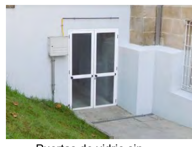
Puertas de vidrio sin señalización, accesos sin señalización visual ni SIA, Acceso 2
