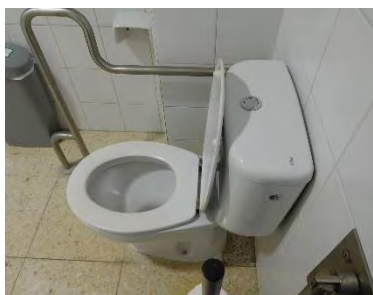
Inodoros con altura y longitud insuficiente
