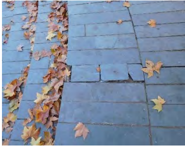
Pavimento deteriorado en E8
