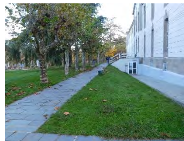
Inexistencia de pasamanos, R5
