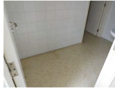
Cabinas adaptadas sin 150 cm en vestíbulo de acceso
