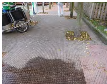
Alcorques sin protección
