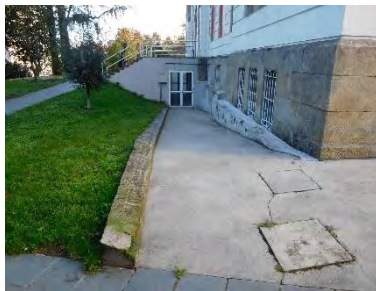
R5, pendiente y longitud de tramo excesivas.
