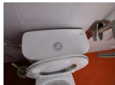
Mecanismo de descarga con superficie insuficiente
