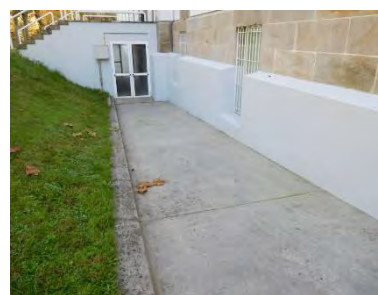
R3, pendiente y longitud de tramo excesivas.
