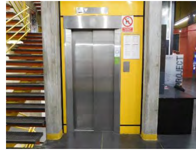
Botonera exterior a altura excesiva
