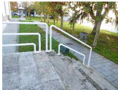
Barreras de protección con huecos superiores a los admisibles, Tipo E6 y E7
