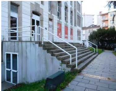
Pasamanos circular no adecuado, Tipo E6 y E7
