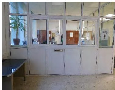
Punto de atención Edificio 1, sin pavimento táctil direccional ni espacio de aproximación
