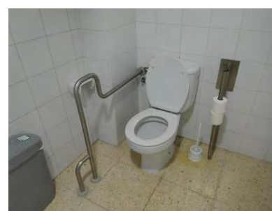
Cabinas sin sistema de aviso en caso de emergencia
