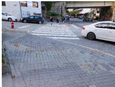
Paso peatonal sin pavimento podo táctil
