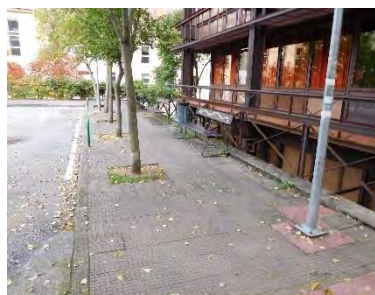
Barreras de protección escalables con huecos excesivos
