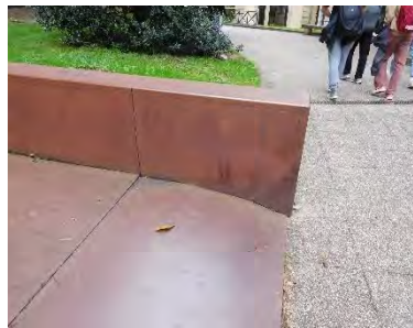
Acuerdo pendiente excesiva en meseta de escalera, pavimento exterior.
