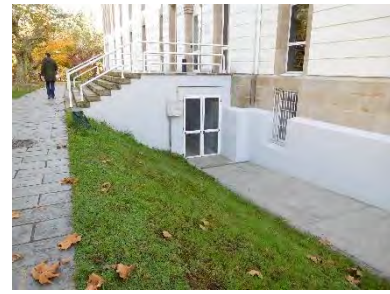
Zonas en talud sin protección de desniveles
