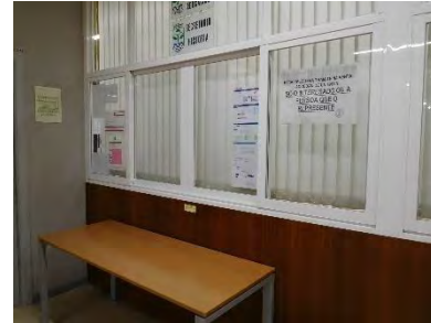
Mostrador de secretaria sin zona accesible
