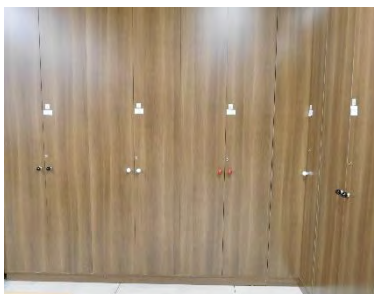
Mobiliario con tiradores e información no accesible en zona de Secretaría
