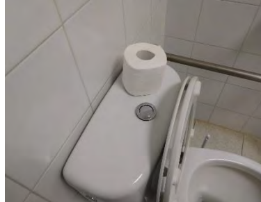
Mecanismo de descarga con superficie insuficiente
