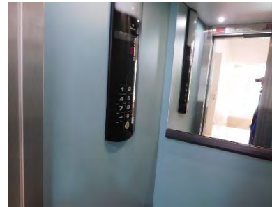
Botonera interior a altura excesiva
