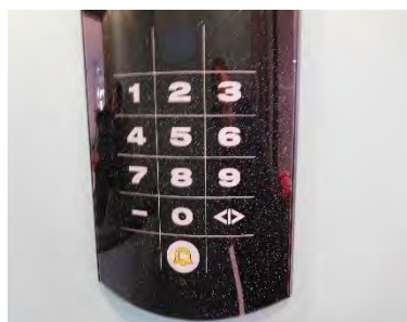
Pulsador de alarma no diferenciado de forma táctil
