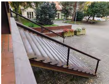
Barreras de protección con huecos superiores a los admisibles, Tipo E2 y E4
