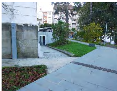
Inexistencia de franjas señalizadoras, R4
