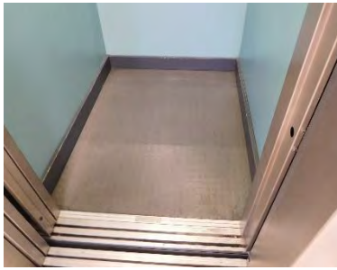
Cabina inferior a la requerida
