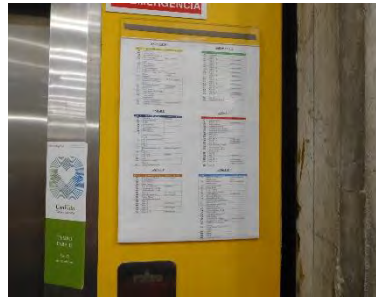
Señalización no adecuada en vestíbulos
