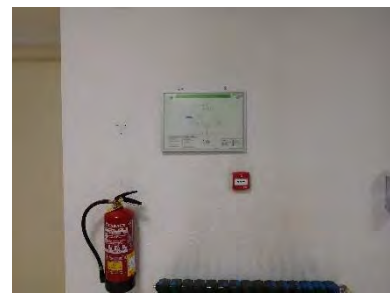
Extintor cambiado de altura, Edif. 1
