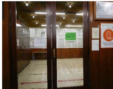
Puertas P4 en Secretaría, requieren fuerza excesiva
