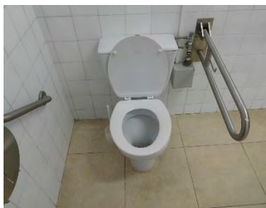
Inodoros con altura de y una longitud insuficiente
