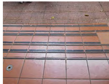
R1, pavimento deslizante y bandas deterioradas.
