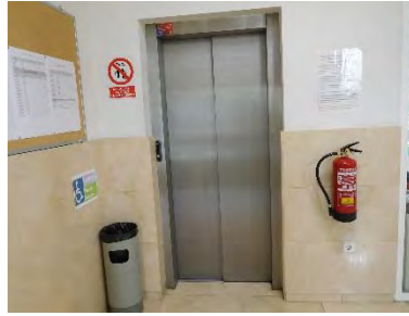
Extintor a altura adecuada, Edif 2
