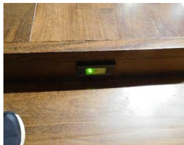
Iluminación de peldaños no enrasada con tabica
