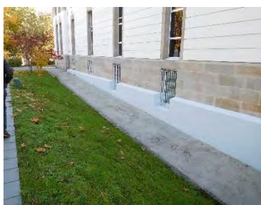
R2, pendiente y longitud de tramo excesivas.
