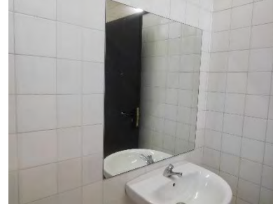
Cabinas tipo C1, C3 y C4, sin dispensadores de jabón
