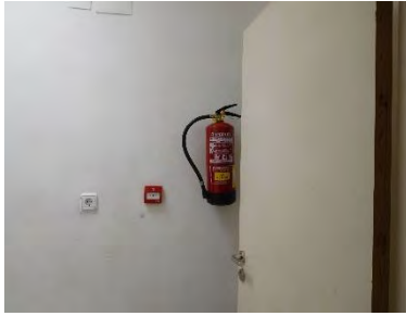
Extintor y pulsador, a altura excesiva, Edif.1
